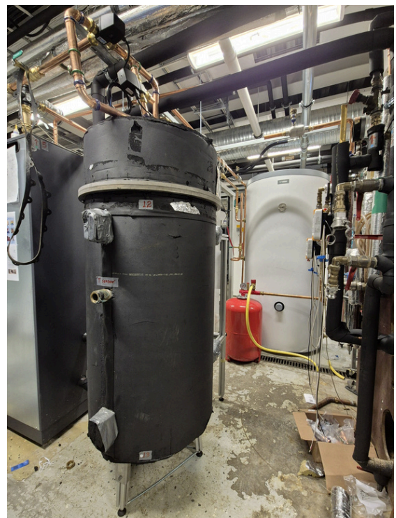
Abbildung 1: Teilsystem für thermische Energiespeicherung des HESS (Stockholm, Schweden)
